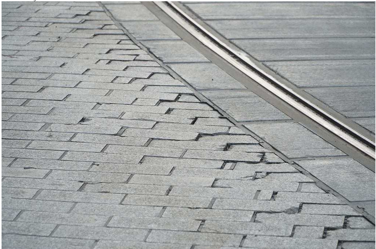
Popękana kostka przy torze Andrzej Kraśnicki jr
