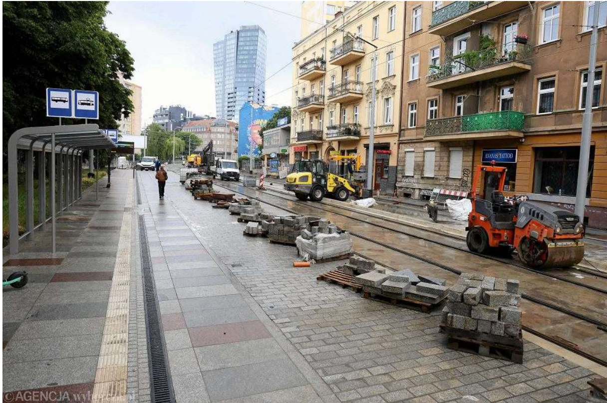
Wymiana torowisk i remont al. Wyzwolenia w Szczecinie. Rejon przystanku 'Lubomirskiego' typu wiedeńskiego. Droga rowerowa ma tutaj taką samą nawierzchnię jak chodnik Fot. Cezary Aszkielowicz / Agencja Wyborcza.pl
