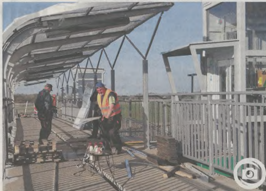
Ostatnie prace przy montażu zadaszenia kładki nad ul. Eskadrową, przy zejściach na przystanki.
