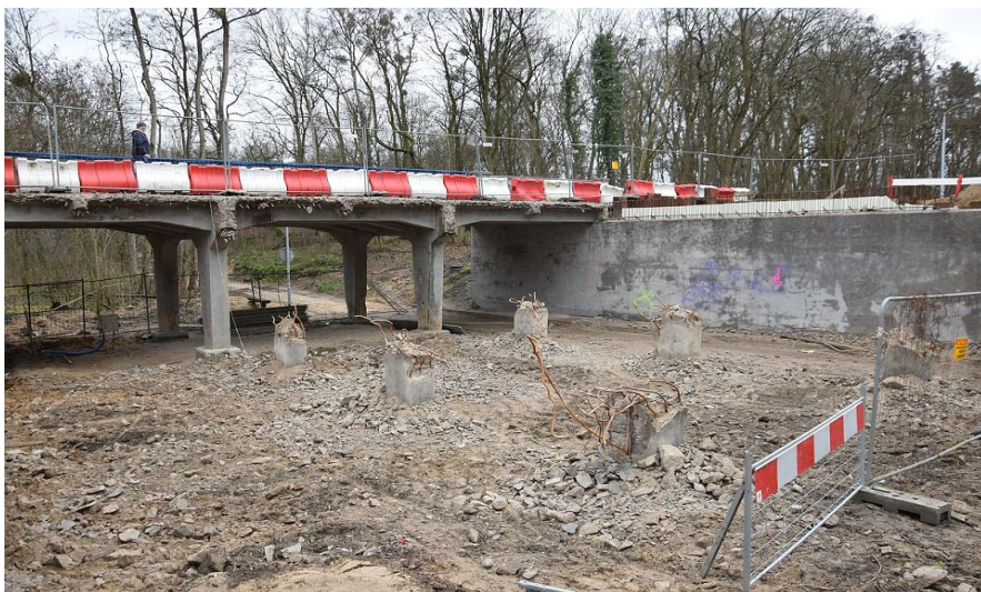
Częściowo wyburzony wiadukt (Andrzej Kraśnicki jr)
