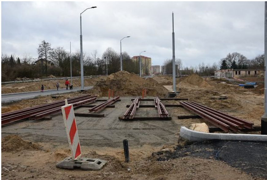
Budowa ronda i torów na skrzyżowaniu al. Wojska Polskiego z ul. Arkońską i Szafera Andrzej Kraśnicki jr
