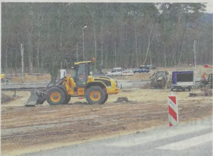
Przebudowa ulic Arkońskiej oraz odcinków ul. Władysława Szafera i al. Wojska Polskiego w Szczecinie.
