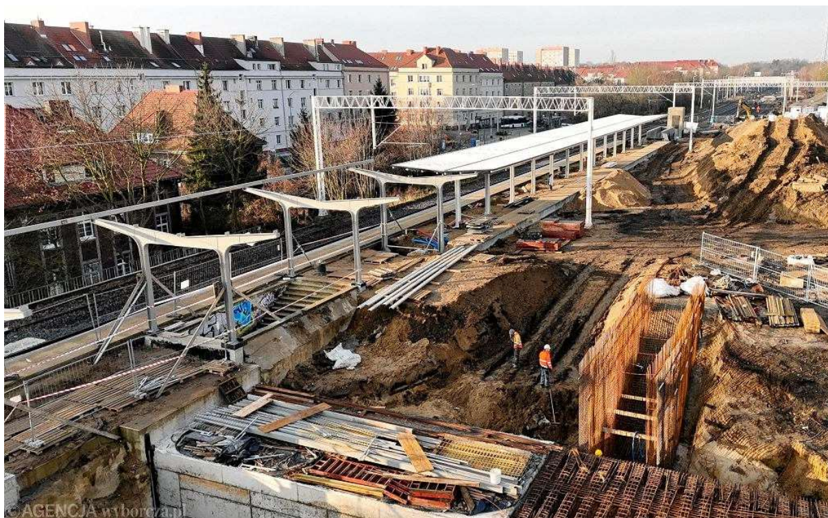
SKM Szczecin Niebuszewo. Widać nitowane konstrukcje starej wiaty, które wróciły na peron Fot. Cezary Aszkiełowicz / Agencja Wyborcza.pl
