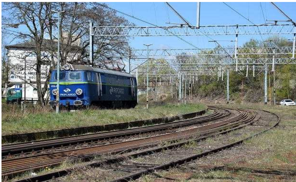
Przygotowania do budowy Szczecińskiej Kolei Metropolitalnej. Druga połowa kwietnia 2020. Stacja Turzyn z przygotowanymi do montażu nowymi szynami Andrzej Kraśnicki jr
