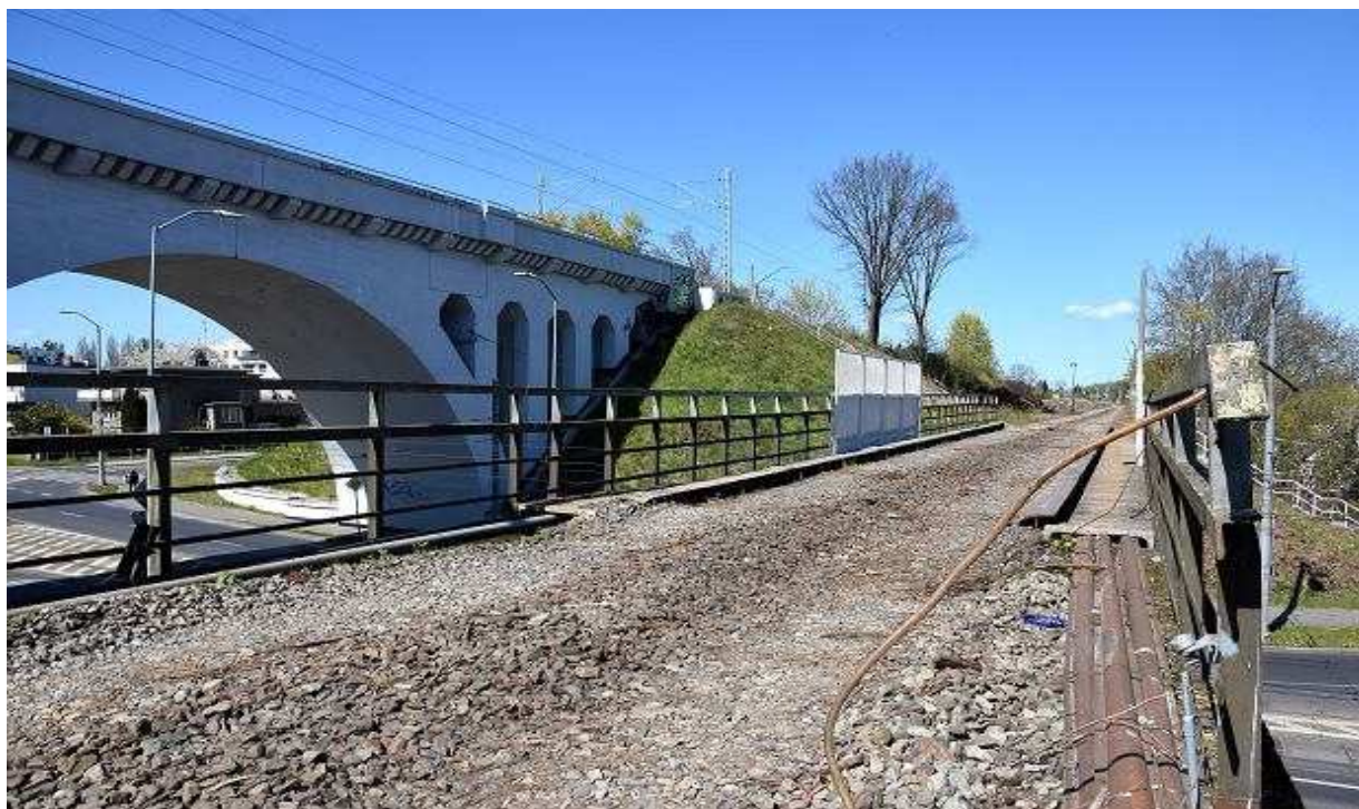
Przygotowania do budowy Szczecińskiej Kolei Metropolitalnej. Druga połowa kwietnia 2020. Wiadukt nad ul. Ku Słońcu. Stary tor został już rozebrany. Powstanie nie tylko nowy. Obok stanie kolejny wiadukt, bo na odcinku Turzyn-Pomorzanany dobudowany zostanie drugi tor Andrzej Kraśnicki jr
