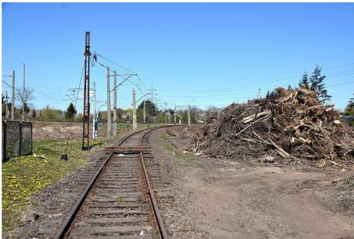
Przygotowania do budowy Szczecińskiej Kolei Metropolitalnej. Druga połowa kwietnia 2020. Tor i wycięte krzaki między stacją Szczecin Turzyn i Szczecin Pomorzany. Powstanie tu linia dwutorowa Andrzej Kraśnicki jr
