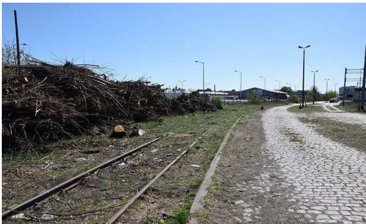
Przygotowania do budowy Szczecińskiej Kolei Metropolitalnej. Druga połowa kwietnia 2020. Pozostałości po towarowej części stacji Szczecin Turzyn Andrzej Kraśnicki jr
