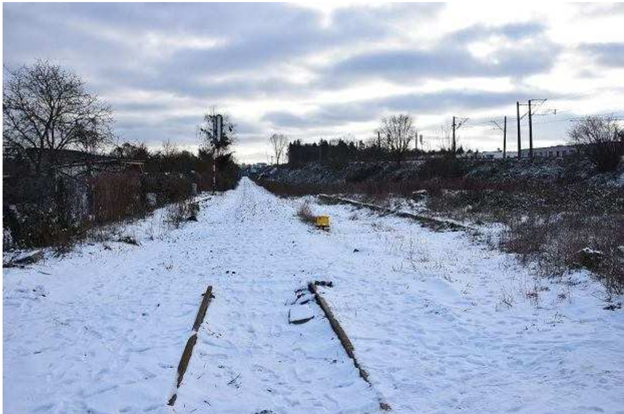
Szczecińska Kolej Metropolitalna w budowie. Widok od strony ul., Kordeckiego w stronę ul. Ku Słońcu. Andrzej Kraśnicki jr
