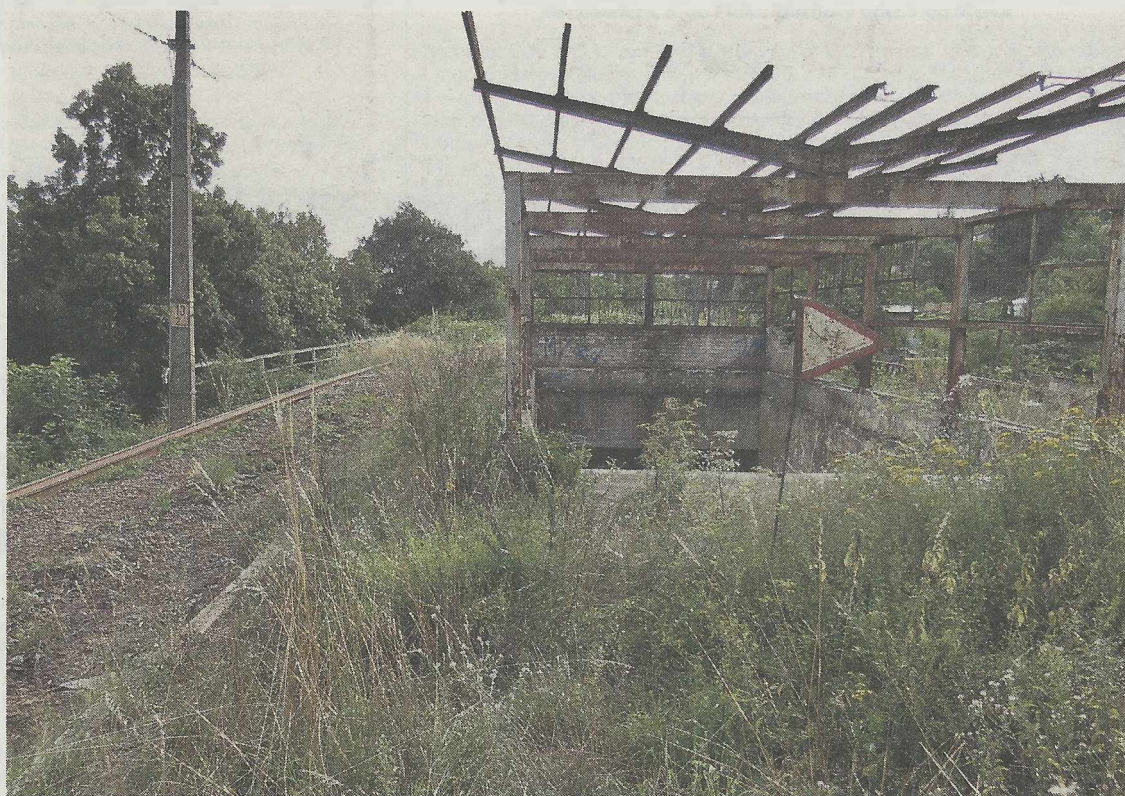
Na duży postęp prac przy budowie Szczecińskiej Kolei Metropolitalnej nie ma w tym roku co liczyć. Fot. Mirosław WINCONEK
