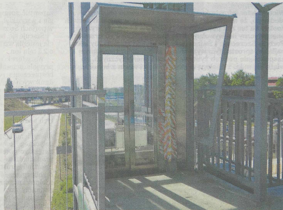
Cztery windy przy kładce nad ul. Hangarową bezużyteczne są od lat i nadal nie wiadomo, kiedy doczekają się napraw.
