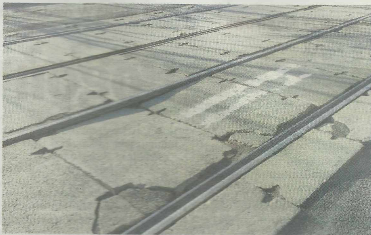
Fatalny stan nawierzchni i torowiska.
