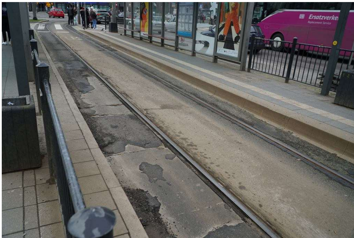
Brama Portowa. Zniszczona nawierzchnia przystanku fot. Andrzej Kraśnicki jr
