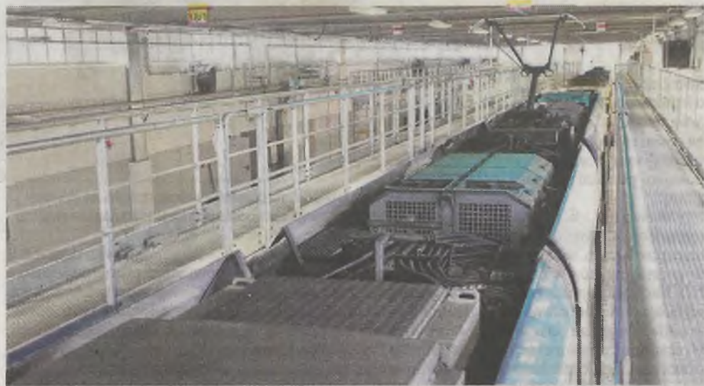
► Mostek nad kanałem - tutaj odbywają się naprawy i przeglądy urządzeń napędowych i sterowniczych tramwajów. Podczas prac na mostku, ze względów bezpieczeństwa, wyłączone jest zasilanie w liniach
