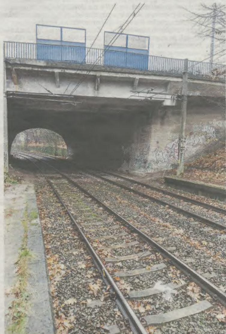
Wiadukt przy stacji Łękno się sypie. Przejazd po nim będzie zabroniony? Gdyby tak się stało, to przez najbliższe lata do właśnie odnowionej (za 130 mln zł) Zajezdni Pogodno nie dojedzie żaden tramwaj.
