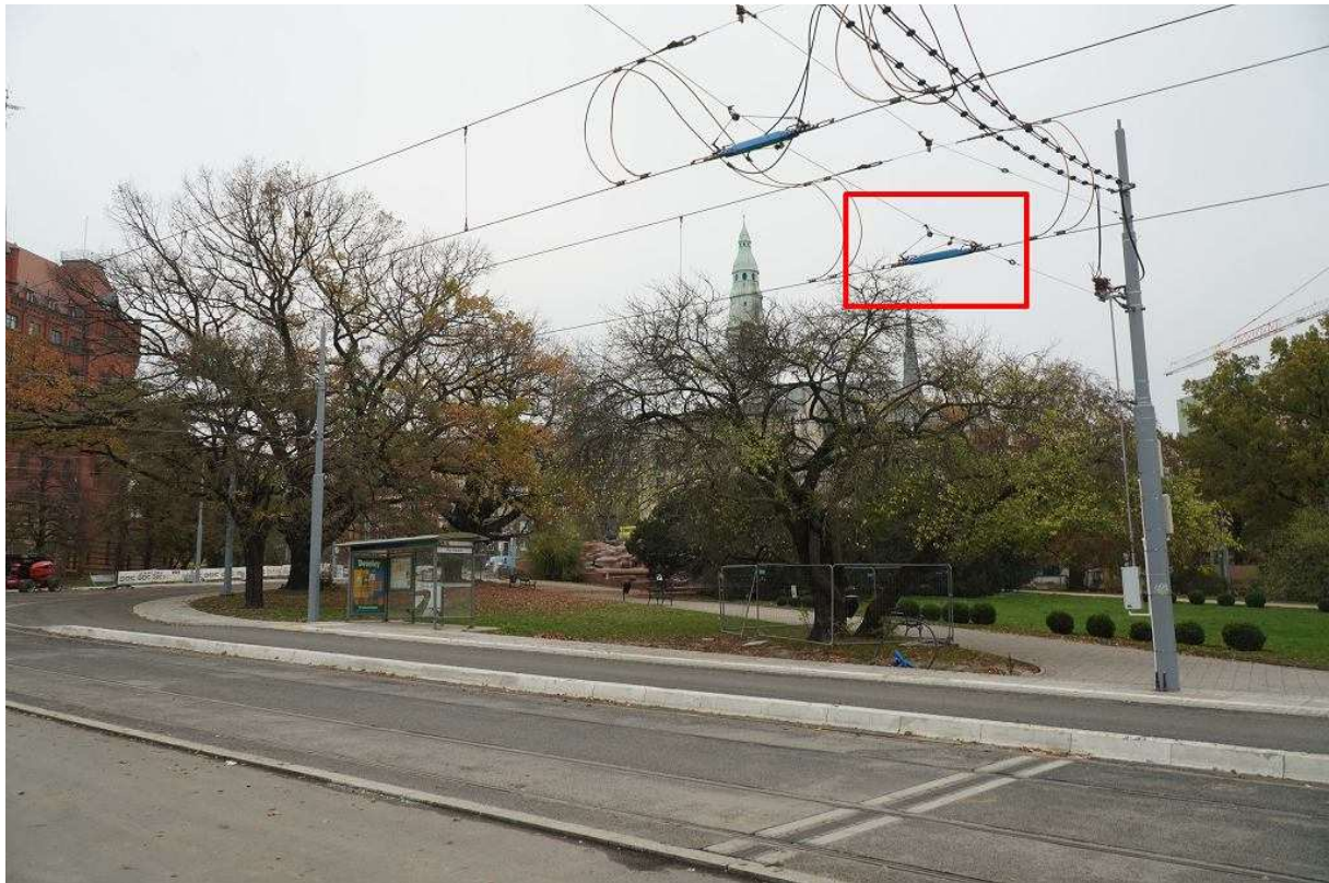
Przejazd testowy tramwaju na Pomorzany. Izolatory w obrębie przystanku, które mogą spowodować problemy fot. Andrzej Kraśnicki jr
