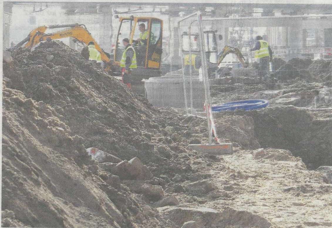
Rejon skrzyżowania ul. Nabrzeże Wieleckie z ul. Dworcową i dalej z ul. Nową i Krzysztofa Kolumba przy wiadukcie kolejowym to plac licznych wykopów.
